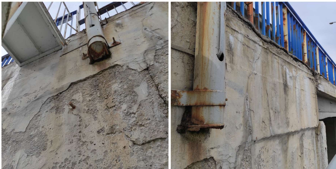
Fot . 8 i 9. Uszkodzenia powierzchni betonów filara w górnej części.
