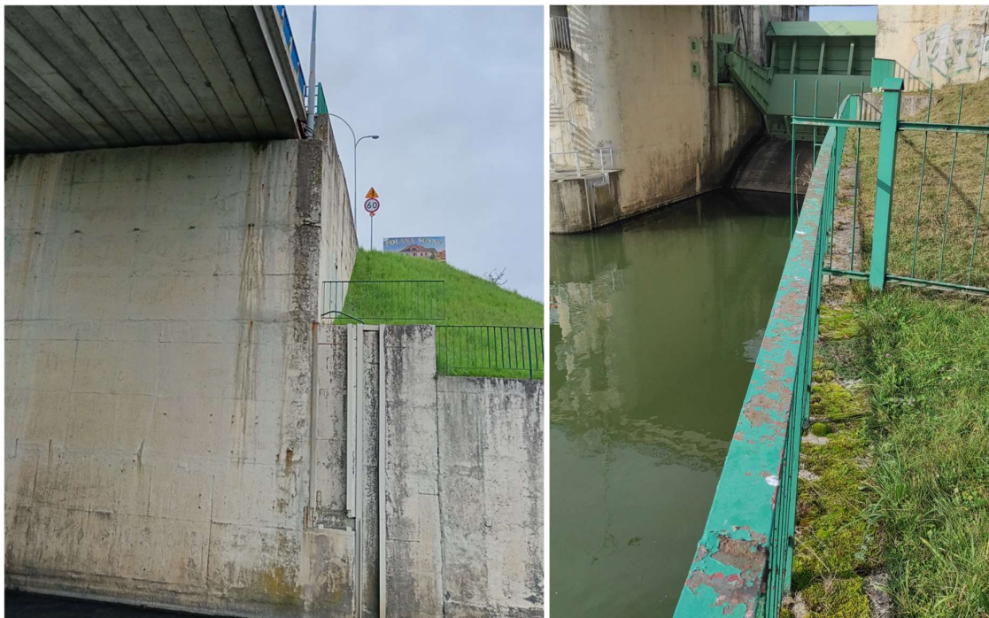
Fot. 4 i 5. Widok od WD na lewy przyczółek i koronę muru oporowego wypadu z jazu.
