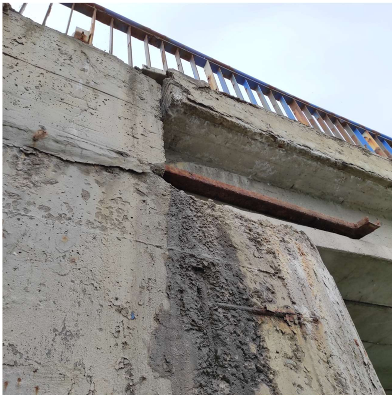
Fot . 11 Uszkodzenia powierzchni betonów filara w górnej części.
