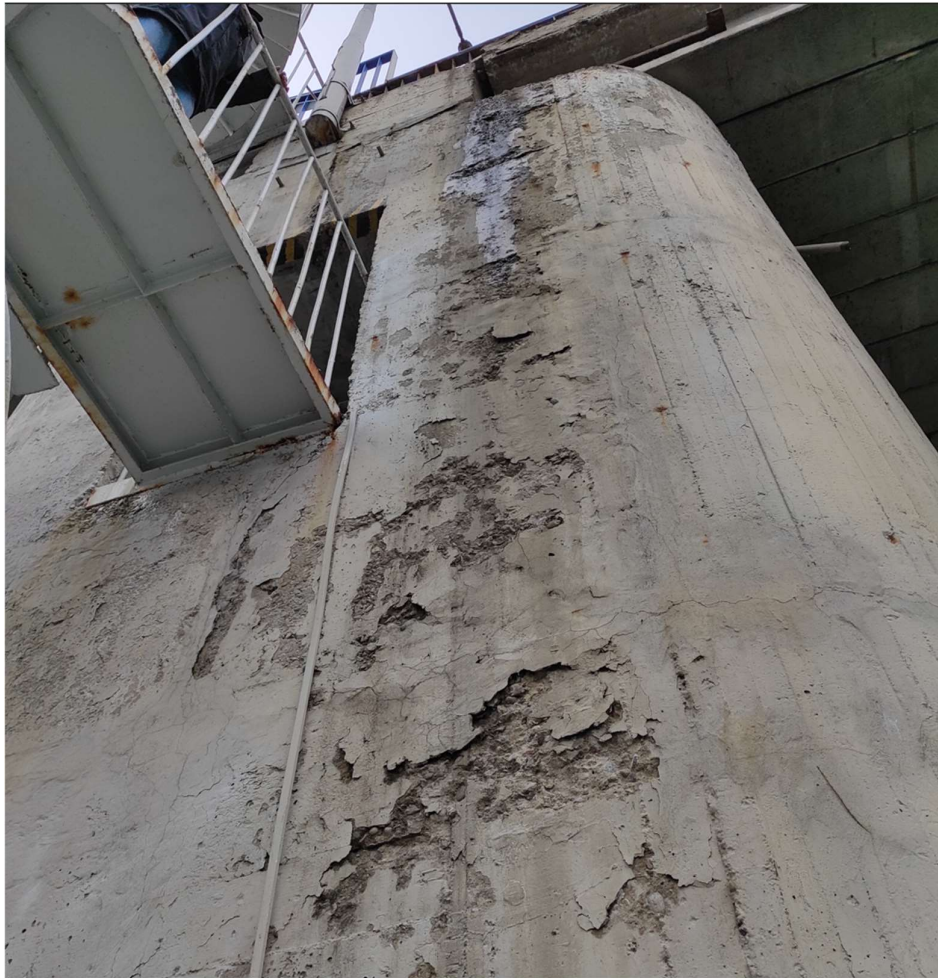
Fot . 12 Uszkodzenia powierzchni betonów filara.
