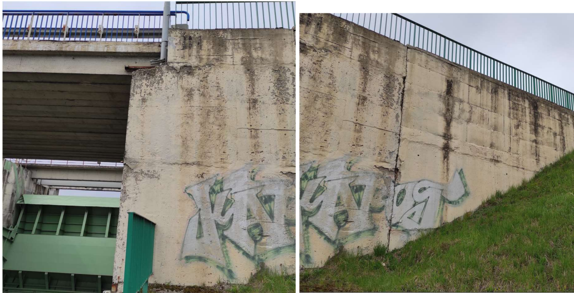
Fot. 2 i 3. Widok od WD na lewy przyczółek i mur oporowy drogi nad jazem.
