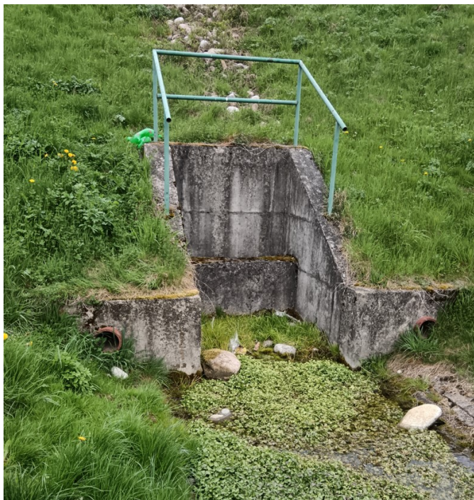
Fot.4 Rów B. Widok na wylot przewidziany do oczyszczenia z porostów i kamieni
