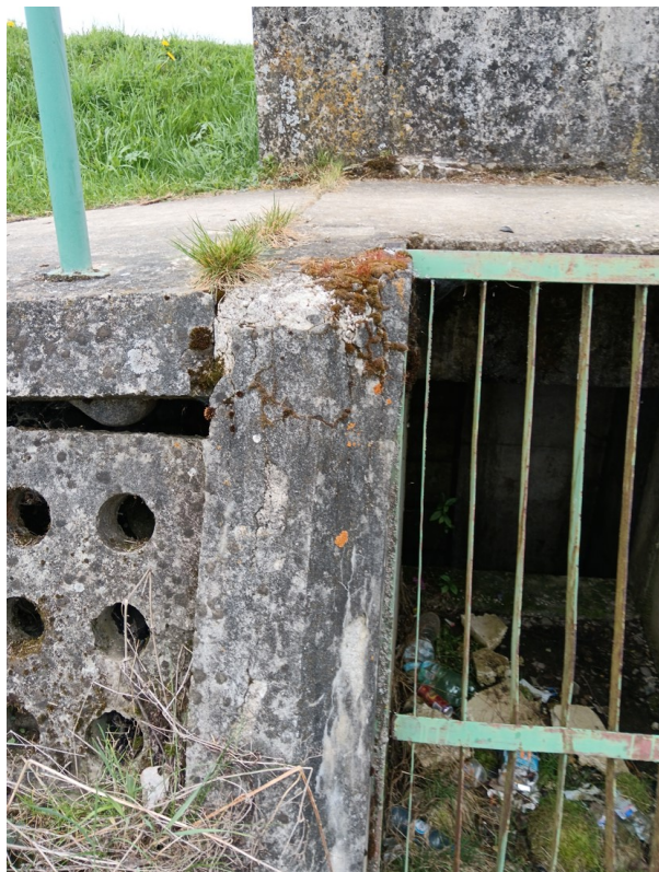
Fot.3 Rów B. Widok na zdegradowane betony ściany czołowej wlotu i pustkę pod ubezpieczeniem.
